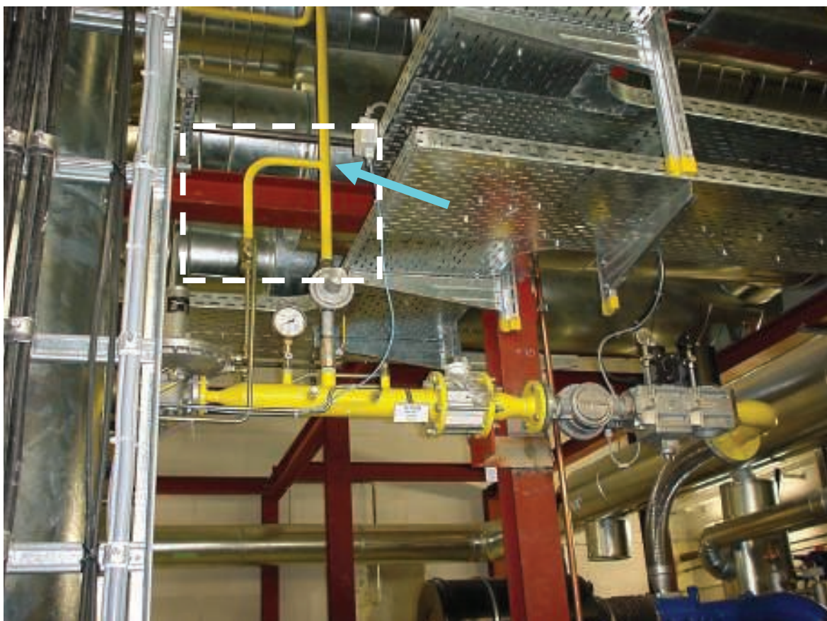
Рис. 7.5 Участок предварительного регулирования с недопустимым объединением продувочного и воздушного трубопровода
